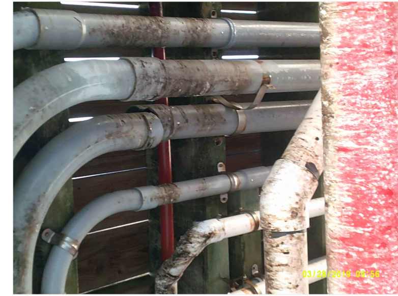
BENT 3: LOOSE ELEC CONDUIT BEND & HANGER
