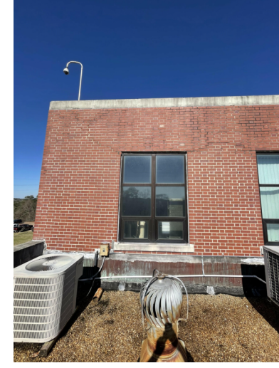
EXISTING EXHAUST FAN 9
