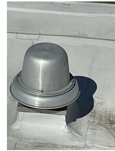
EXISTING EXHAUST FAN 2
