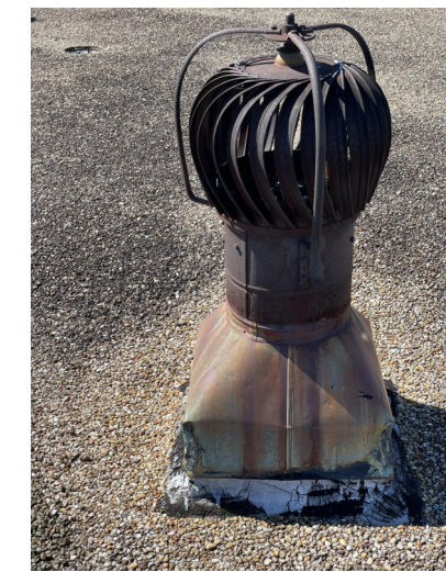
EXISTING EXHAUST FAN 2
