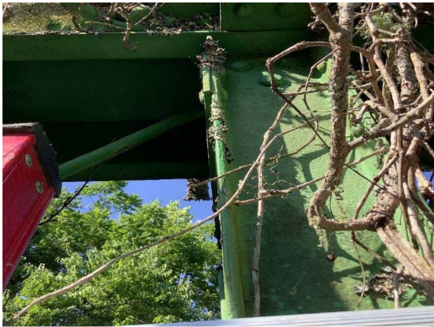
CRACK U3-L3 LEFT SIDE
