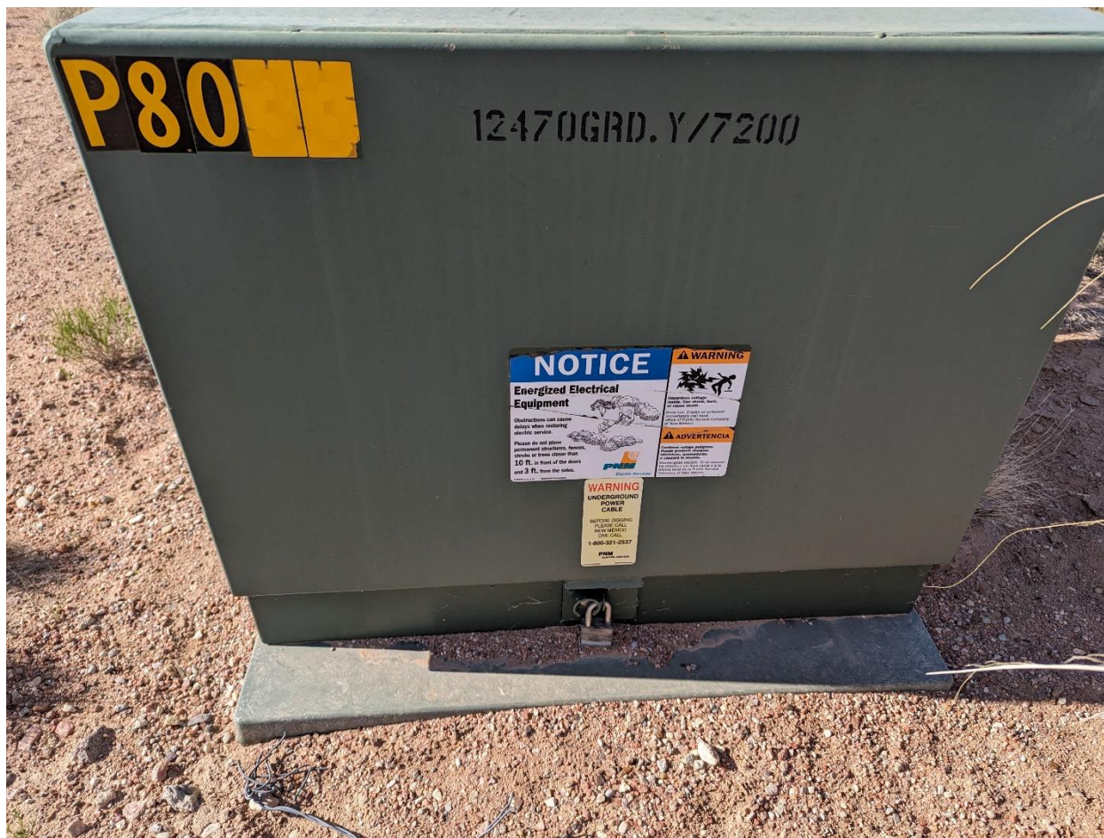
Transformer on lot 9A .jpg
